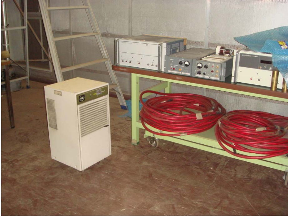
写真 1 望遠鏡フロアに設置された除湿器
