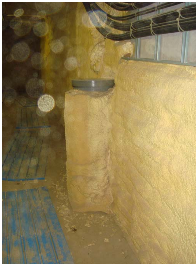
写真4 階下の水抜き用深井戸（蓋がされている）
