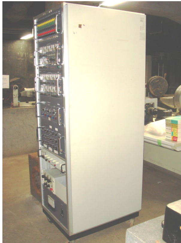
写真12 マグネトグラフ制御架
