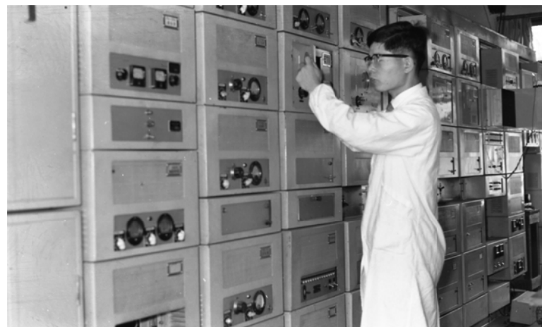
写真6 保時室の様子
