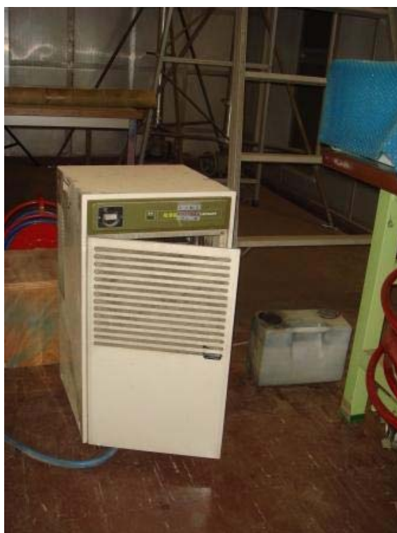
写真1 タンクをやめてホースを繋いだ除湿機
