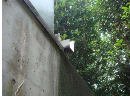
写真 7 樋から滴る排水
