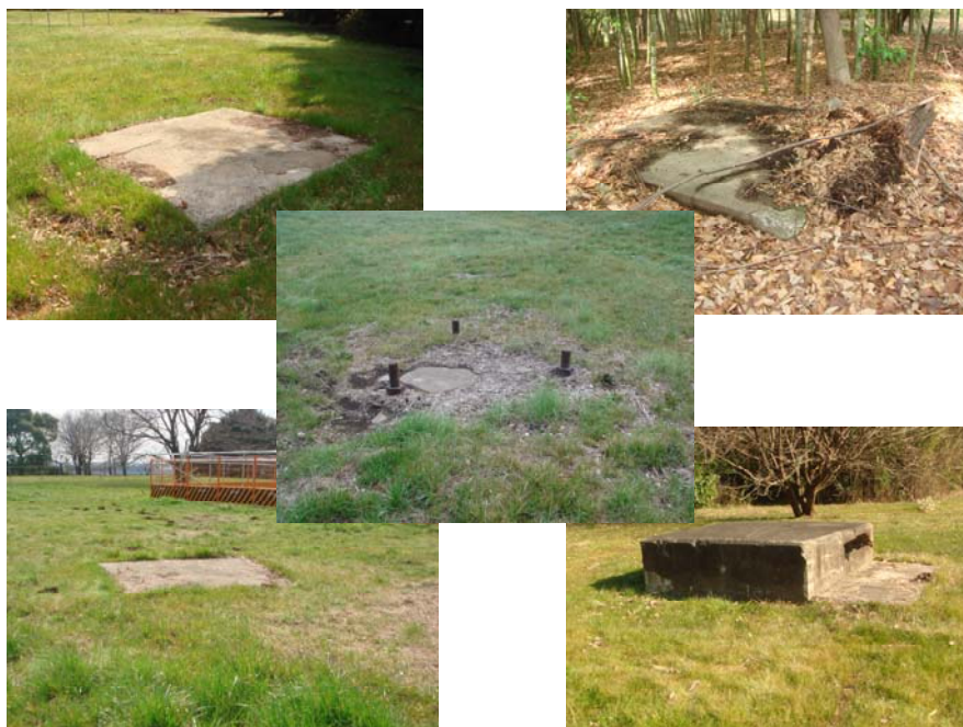
図2(写真) 図1の⑧の位置の鉄塔基礎とステアの基礎
