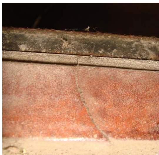
写真7 見つかったひび割れ
