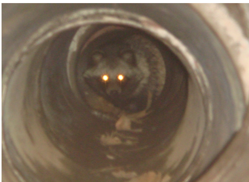
写真1 自然換気通風口の中の「たぬき」
