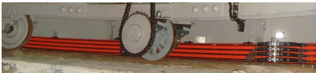
写真3 ドーム内壁に取り付けられたトロリーと集電子
