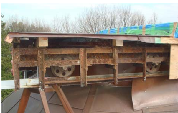
写真7 損傷のひどいドーム扉の車輪、レール
