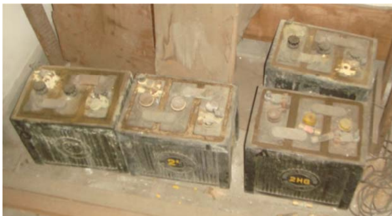
写真3 太陽塔望遠鏡棟にある鉛蓄電池
