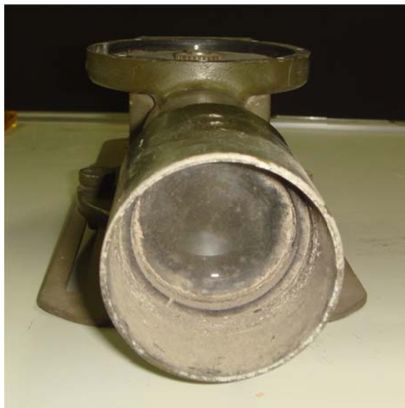
写真5 レンズ側から見たエルボーの様子
