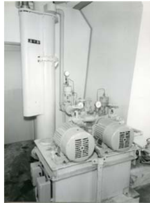
写真8 観測床油圧装置
