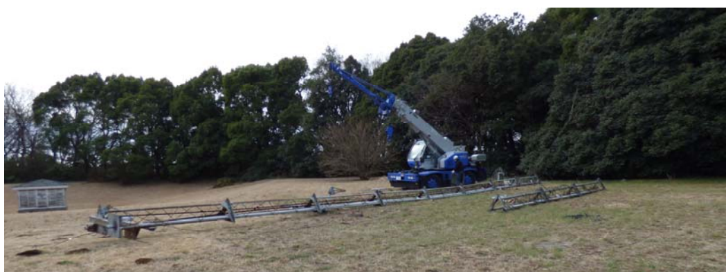
写真8 地上に倒された鉄塔
