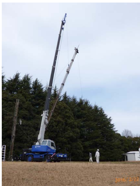
写真 6 傾けられ倒される鉄塔
