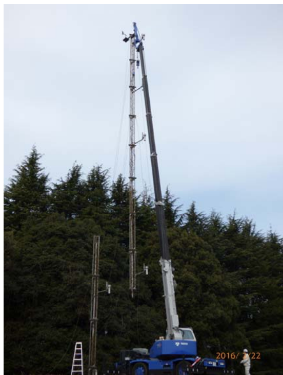
写真 5 途中で切り離された鉄塔
